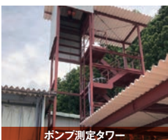
ポンプ測定タワー
